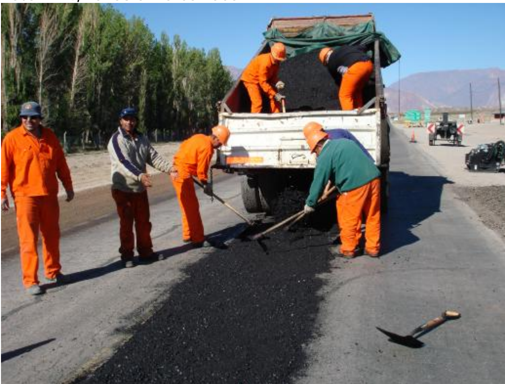
Foto N° 4, Fallas en la Calzada
